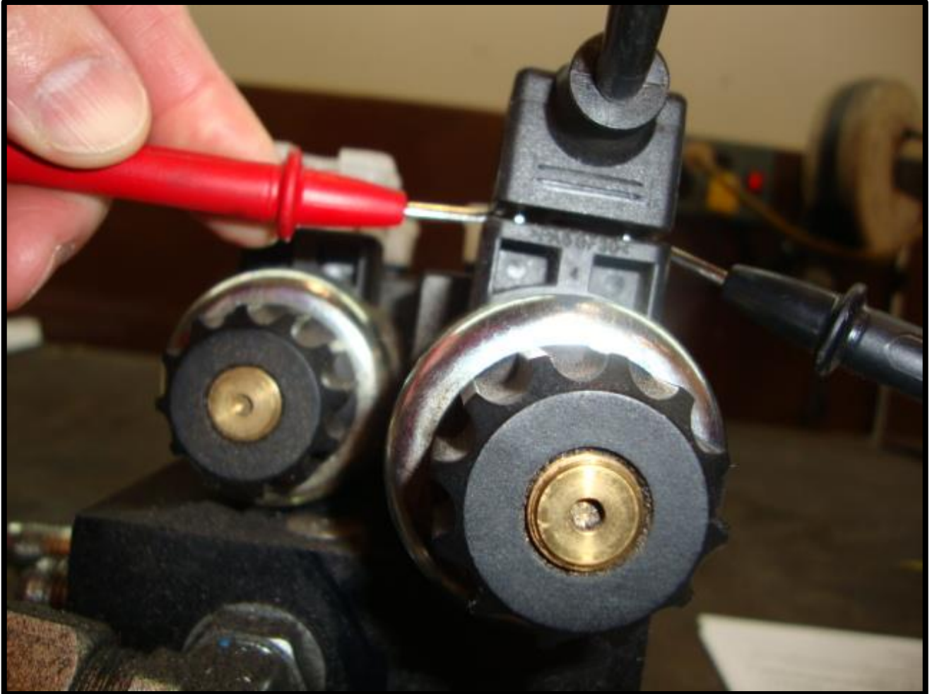
Fig. 8-4 Checking Din Plug Voltage
