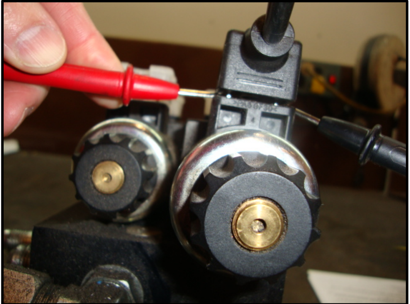
Fig. 8-4 Checking Din Plug Voltage
